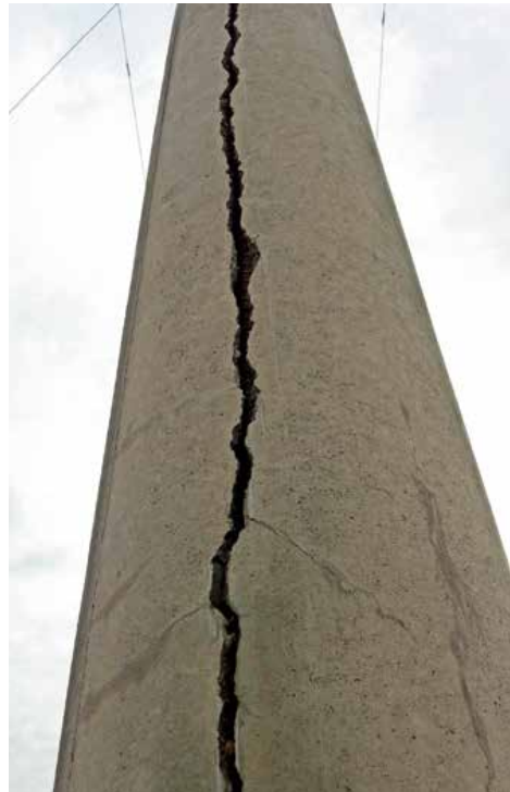
Sanacija velikih razpok na betonskih stebrih je draga, ponekod celo dražja od postavitve novega stebra.
